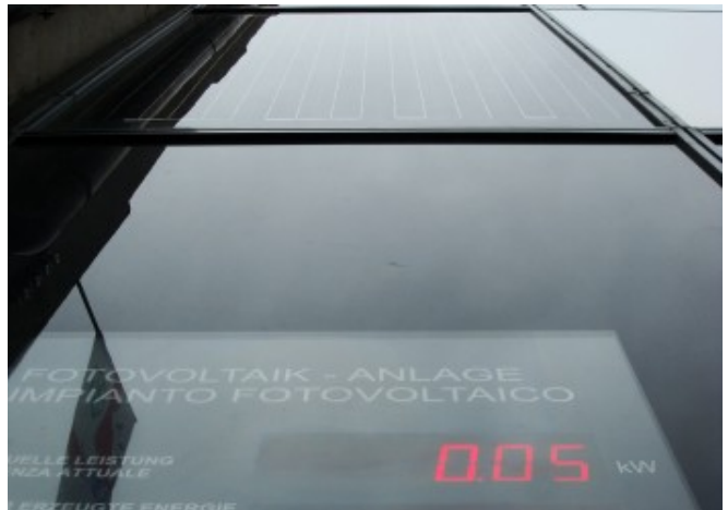
Die Photovoltaik-Ausgabeleistung wird an der Fassadenoberfläche angezeigt © Eurac Research
