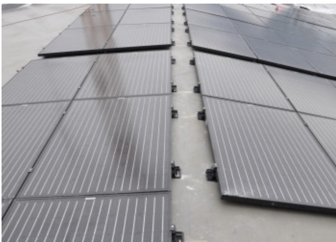
Ein Zwischenraum zwischen den Modulen wurde als Durchgang für Wartungsarbeiten freigelassen © Elektrostudio
