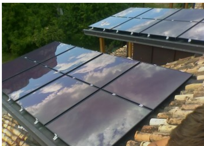
I moduli sono distanziati dalle lamiere metalliche degli abbaini © PVEnergy
