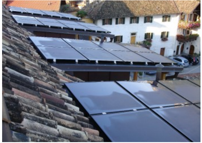
Die BIPV-Anlage ist nur wenig geneigt: Dies erfordert besondere Aufmerksamkeit bei Schneefällen © Gebäudeeigentümer
