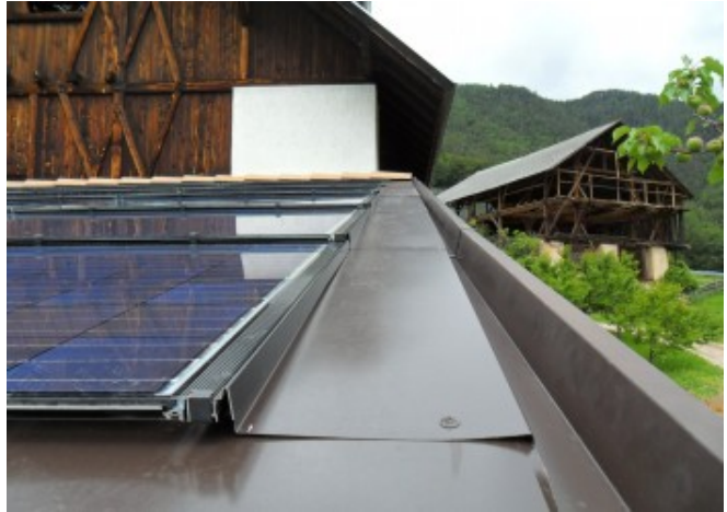
Die moderne PV-Technologie wurde in einen traditionellen Kontext eingebettet © Ing. Studio Blasbichler Srl
