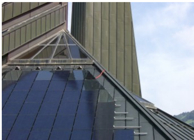
Bauphase, das Blechdach der Kirche und das BIPV-Montagesystem sind immer noch sichtbar © Eurac Research
