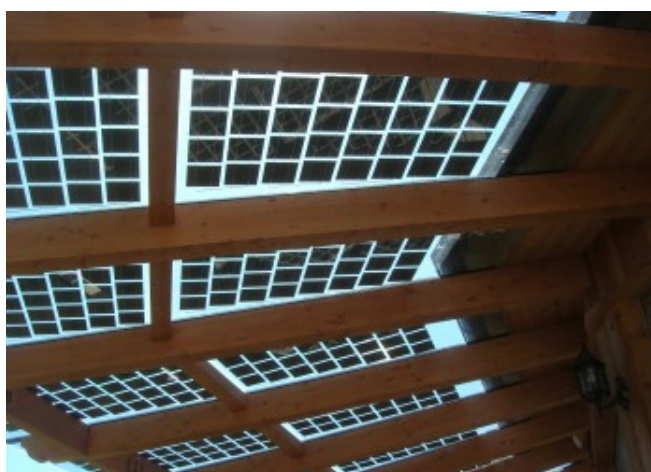
La struttura in legno nasconde il sistema di fissaggio dei moduli © Augustin Clement
