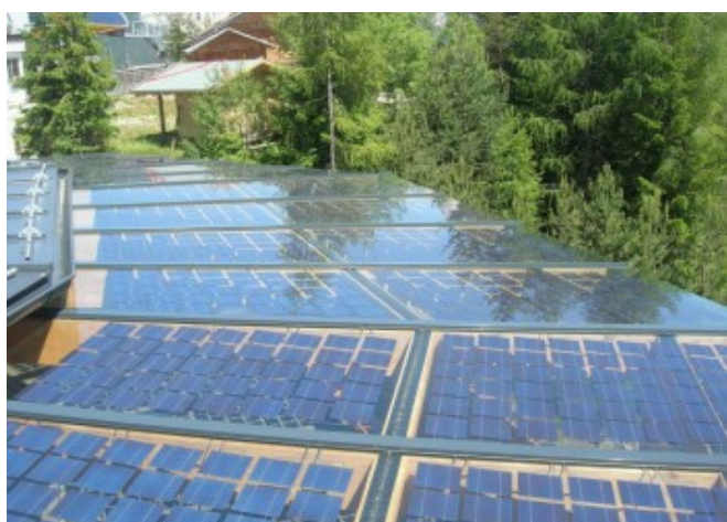
Vista dall'alto della tettoia BIPV: le canaline visibili proteggono i cavi elettrici © Augustin Clement
