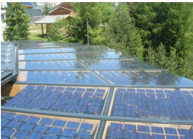
Blick von oben auf das BIPV-Glasdach: die sichtbaren Kabelschächte schützen die elektrischen Leitungen © Augustin Clement
