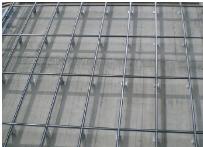
Struttura in acciaio a supporto dei moduli che coprono le facciate opache dell'edificio © Günther Wallnöfer
