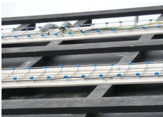
Sottostruttura in legno dei moduli: sono visibili i cavi e i pannelli in cartongesso ignifugo © Leitner Electro Srl
