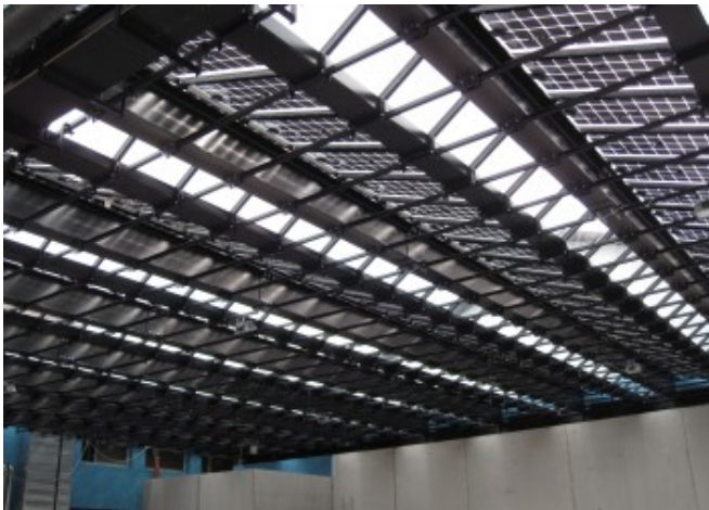
Detailansicht der Tragstruktur der BIPV-Anlage © Colterenzio Winery
