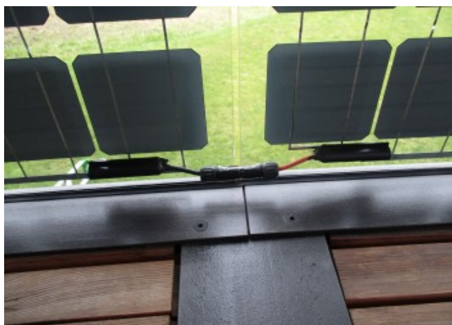
Vista dettagliata delle giunzioni dei cavi elettrici © proprietario edificio
