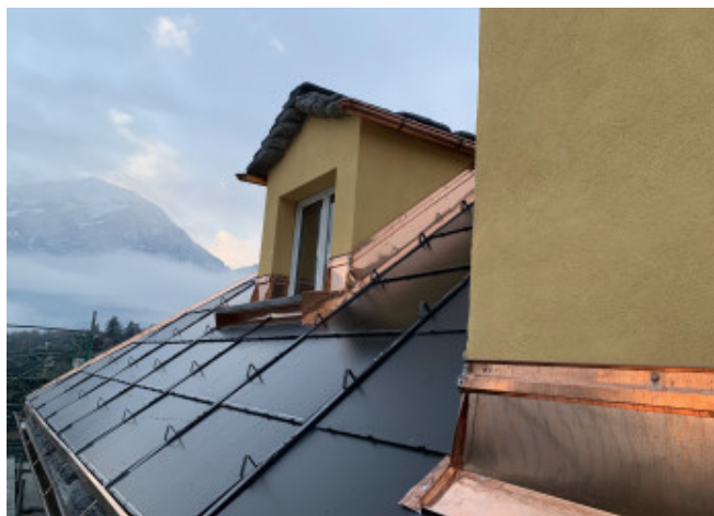
Modulo fotovoltaico integrato su tetto storico
