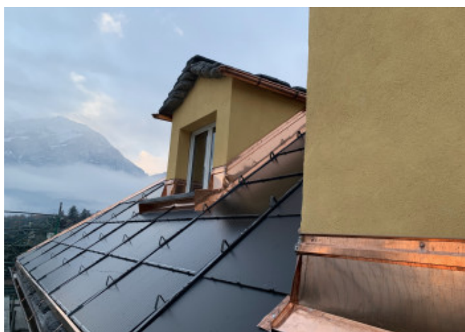
Modulo fotovoltaico integrato su tetto storico
