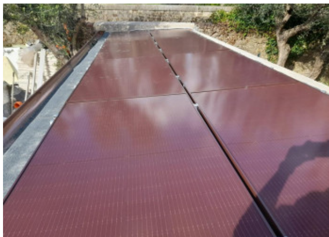
Particolare dei moduli fotovoltaici installati
