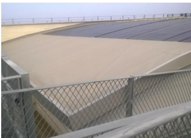
Perfekt an das gewölbte Dach angepasste BIPV-Module © Alberto Ferrero
