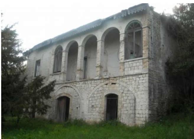
Zustand der Süd-Südost-Fassade vor der Intervention © Arch. Patrizia Trivisonno
